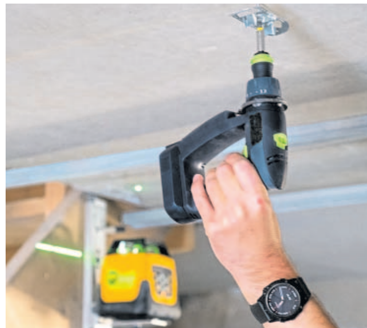
Der Nivellier-Laser im Hintergrund gibt die Höhe vor. Sobald der Prototyp des Schraubers die Position erreicht hat, stoppt er automatisch
